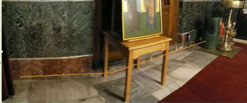
Έργο Δάκτυο Κλιματισμού Ιερού Καθεδρικού Ναού Αγίας Σοφίας Θεσσαλονίκης. Φος 2021 ©. Θεοδοσοπούλης Μην., Μηχανικός
