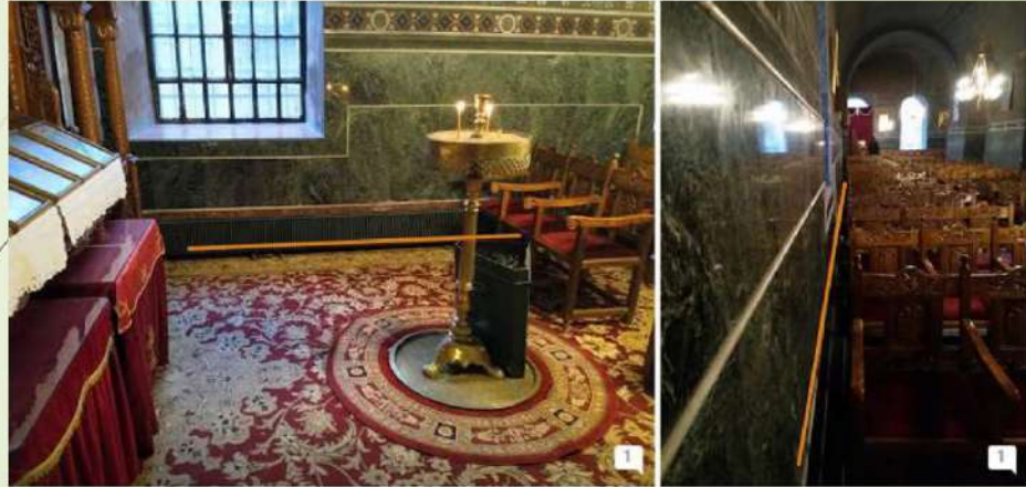
Έργο Δίκτυο Κλιματισμού Ιερού Καθεδρικού Ναού Αγίας Σοφίας Θεσσαλονίκης. Ώς 2021 Θ. Θεοδοσοπούλης Μητ. Μηχανικός
